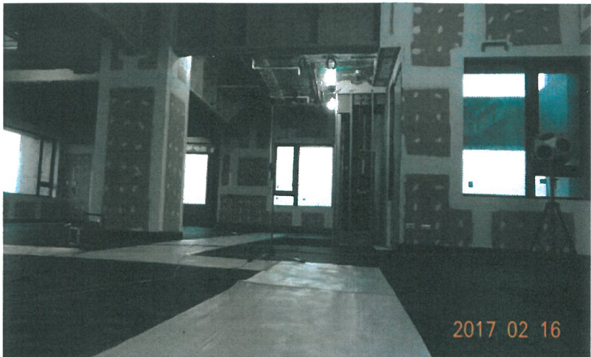
圖 12、測試 25 樓 A3 戶樓板無鋪設表面材時 受音室(24 樓 A3 戶)之麥克風量測照片
